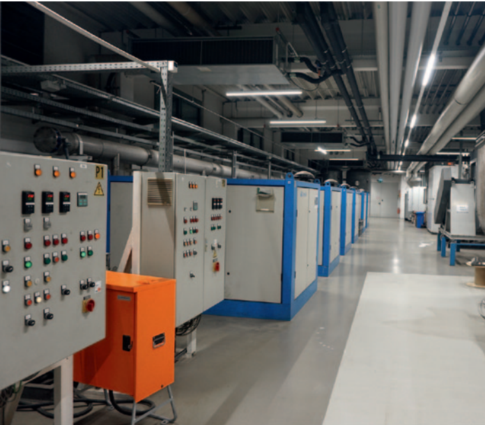
Die Druckluftkompressoren sorgen für Druckluft an den Bädern, wodurch die Verschleppung von Flüssigkeit verhindert wird
